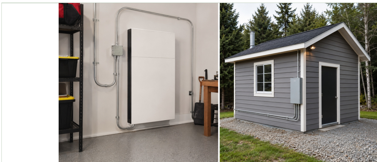
À gauche : batterie résidentielle. À droite : alimentation électrique d'un atelier séparé.
