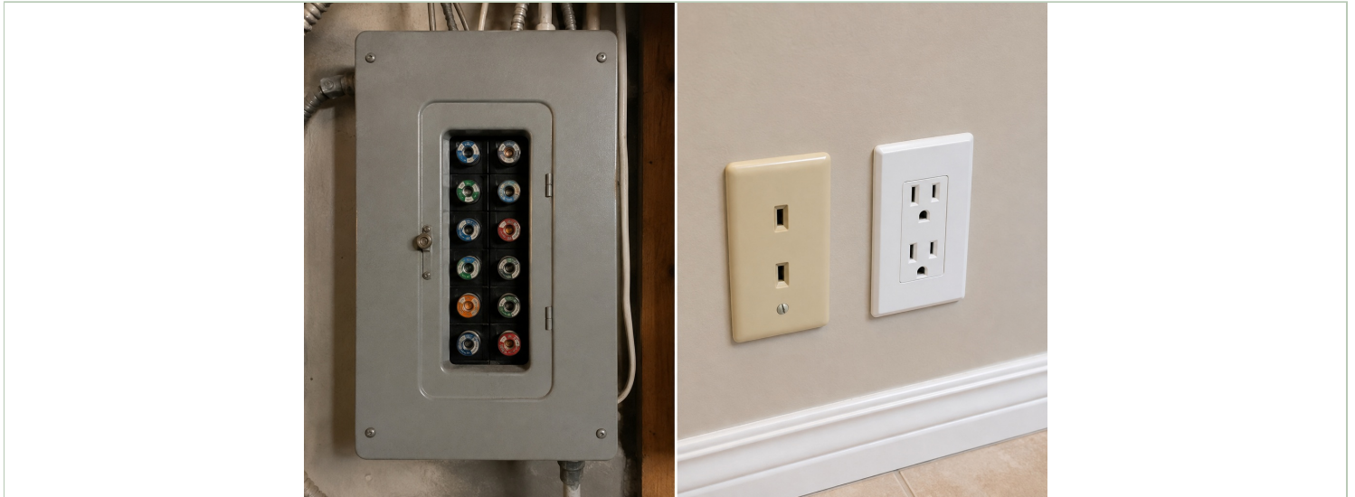
À gauche : panneau à fusibles. À droite : ancienne prise à deux fentes et prise moderne à trois fentes.
